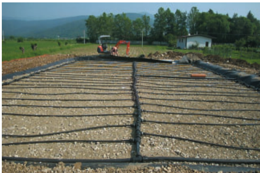
Il sistema di sub irrigazione realizzato per la distribuzione del refluo da affinare proveniente dalla vasca di equalizzazione
