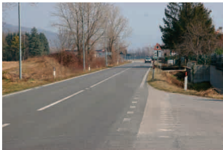
Realizzazione di un tratto di rete fognaria in Sanguarzo, asfaltatura ed estensione dell'illuminazione pubblica
