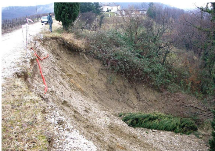
Foto F01 frana novembre 2010.
